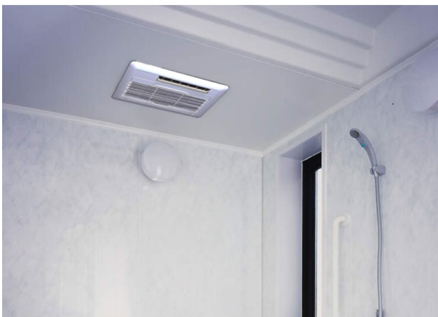
浴室の天井に設置
