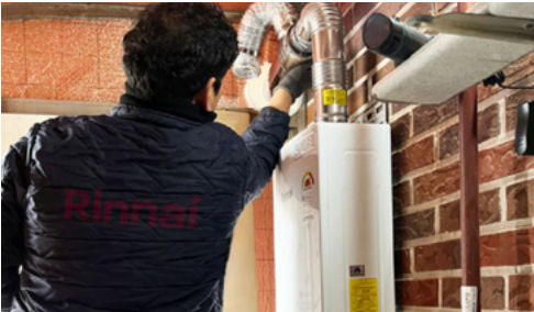
ボイラーを無償提供
