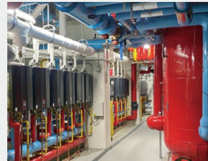
ストック型の収益拡大が見込める業務用給湯システム
