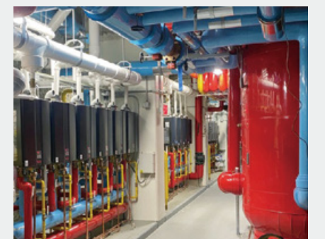
ストック型の収益拡大が見込める業務用給湯システム
