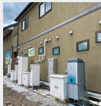
設置された水素100%燃焼給湯器
