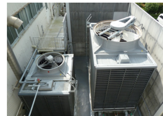
循環システム冷却棟(写真左)
