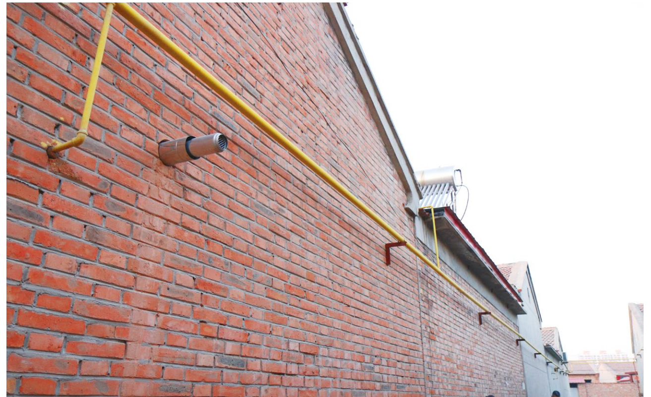
急ピッチで整備されたガスパイプライン(黄色い管)と壁から露出したガスボイラーの排気筒
