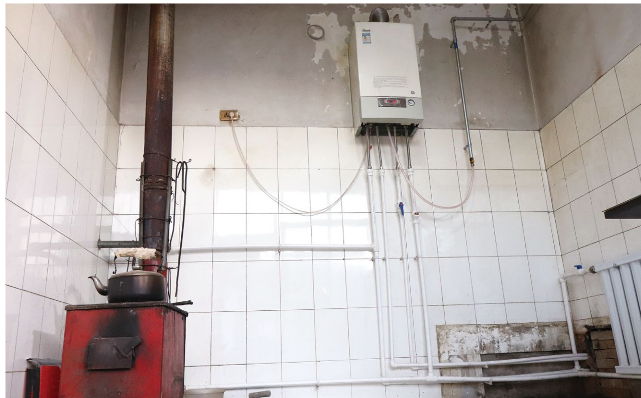
これまで使用されてきた石炭ボイラー(左下)と切り替えられたガスボイラー(右上)
