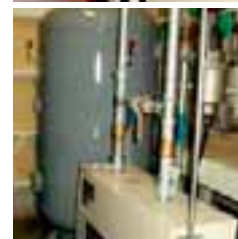
レシーバータンク
